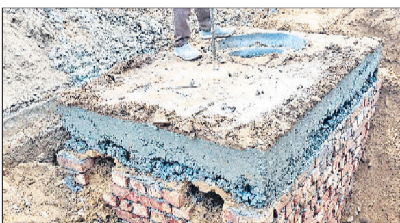
बहल। कस्बे में चल रहे सीवरेज के काम में बनाया गया चैंबर जिसका लेंटर सही नहीं डाला गया है।
